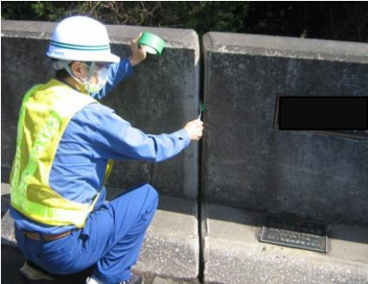
既存目地材を撤去し、ワイヤブラシ等でゴミ・埃を除去清掃を行う。
