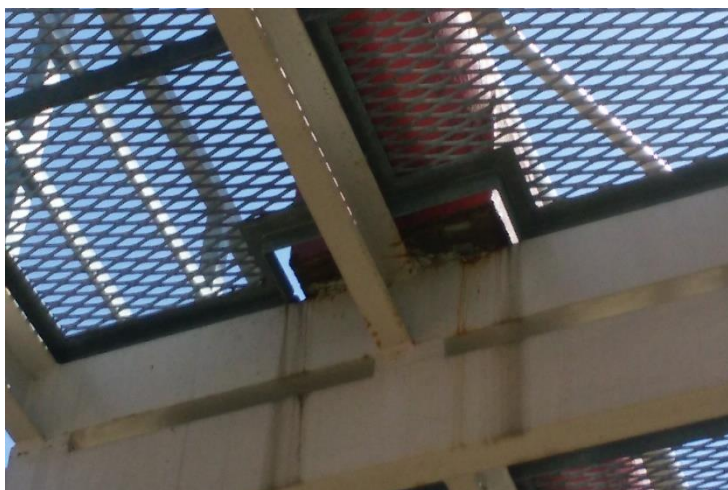
歩行用板固定ボルト等の貫き錆箇所
